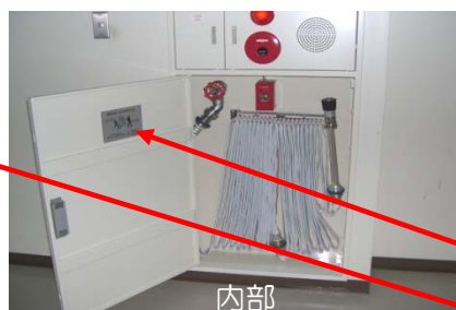
屋内消火栓・補助散水栓
